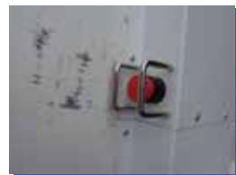
非常押しボタン
