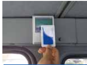
セキュリティコントローラー （専用磁気カードで警備開始／解除）
